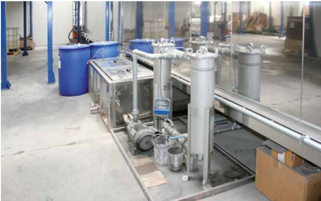
8 – Particolare dell'operazione di pretrattamento monostadio: vasca di contenimento del Toran 3, filtri e pompe di erogazione.
