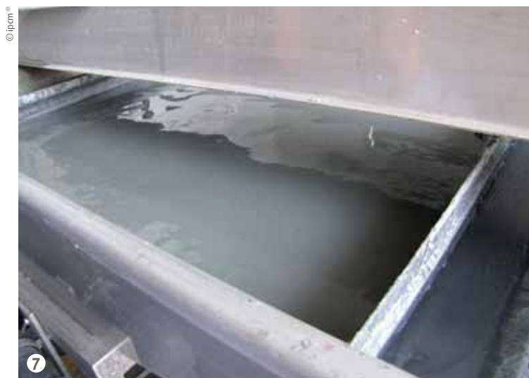
Figura 7: La vasca di acqua depurata.
