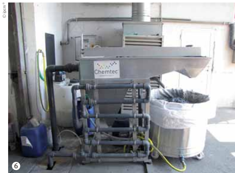
Figura 6: L'impianto di depurazione delle acque installato da Chemtec.
